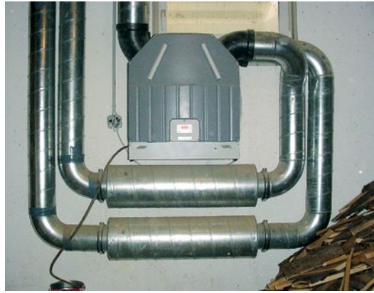
Abb. 44 | Lüftungsgerät mit Wärmetauscher und Schalldämpfer
